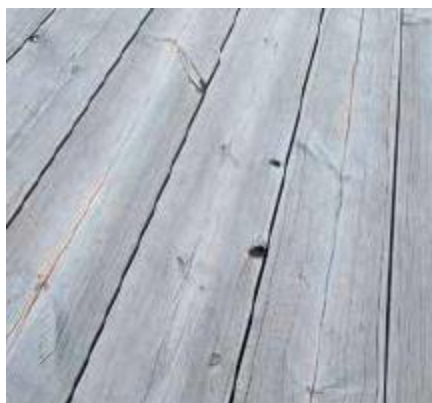
Niezaimpregnowana deska tarasowa Lunawood (Thermososna) 2 lata po montażu. Na powierzchni widoczne są niewielkie pęknięcia włoskowate.
